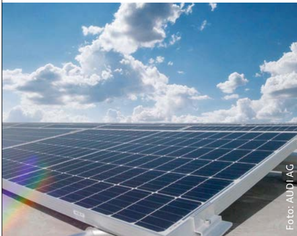
Audi Hungaria: Photovoltaik-Anlage auf den Dächern der beiden Logistik- hallen
